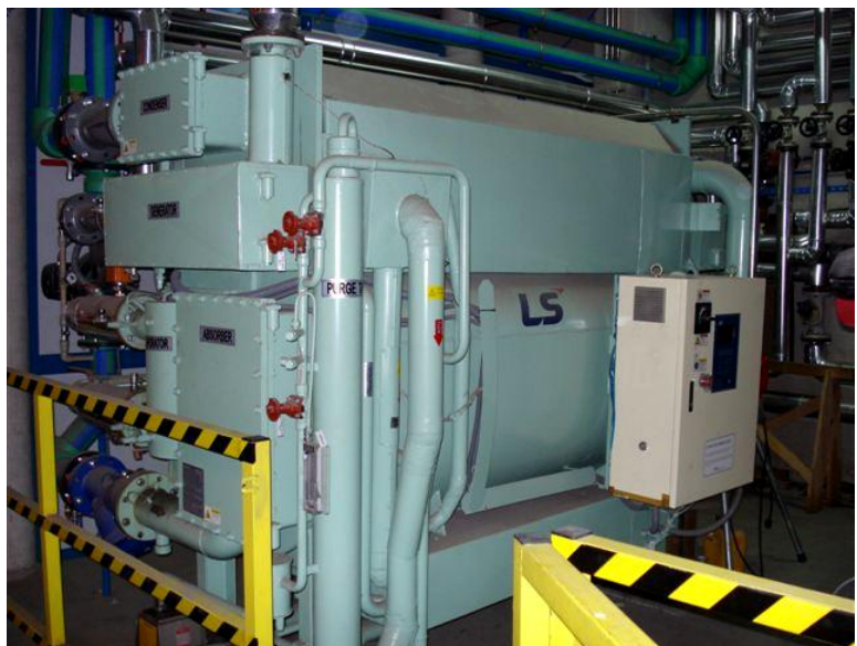
Refrigeración por absorción (200 kw). Fábrica de puertas Norma (Soria)
