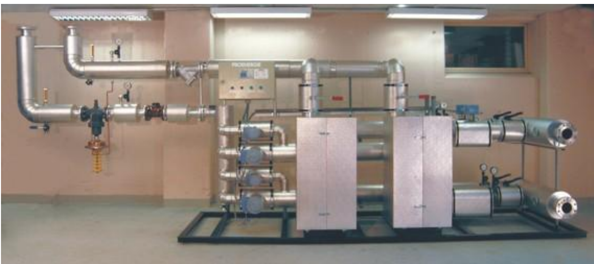
Subestación principal 1´8 MW
