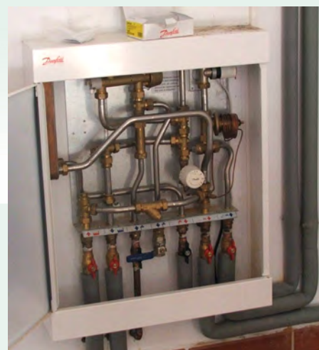
Detalle de una de las tres subestaciones instaladas. Este elemento constituye el punto de intercambio de calor entre la red y cada uno de los edificios. Sustituyen las calderas individuales en un mínimo espacio, reduciendo costes de instalación y mantenimiento.
