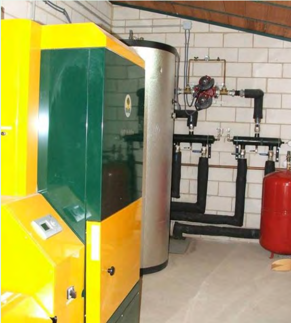
Sala de calderas: caldera, depósito de inercia y sistema de bombeo.
